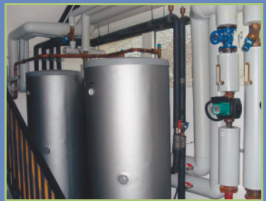
Heizzentrale in der Sporthalle der Grundschule in Stotel.
